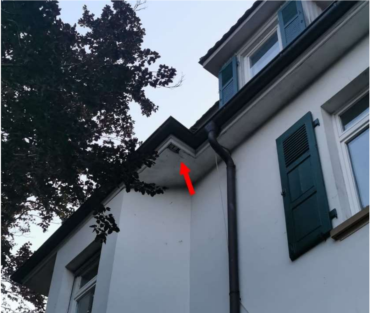
Abbildung 11 Beschädigung (roter Pfeil) in der Fassade der alten Villa, vermutlich von mehreren Zwergfledermäusen als Quartier genutzt
