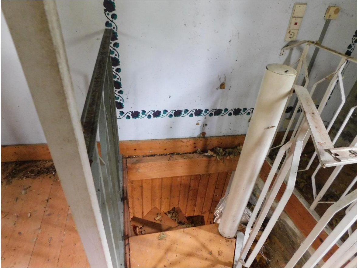
Abbildung 11 Innenraum des mittleren Holzturmes mit zahlreichen Kotpellets und Nahrungsresten
