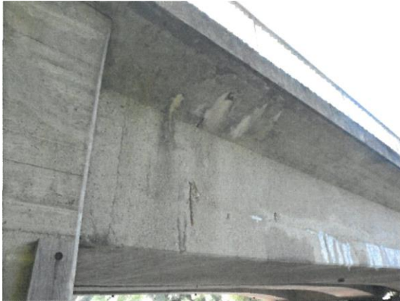
Aussinterungen Arbeitsfuge Trogplatte / Trogwand
