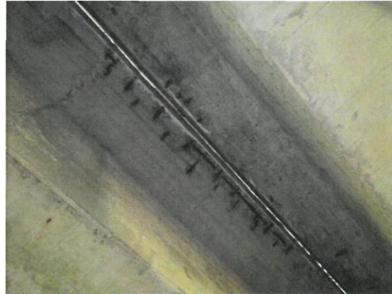
Betonabplatzungen, freiliegende Bewehrung Kragarmunterseite
