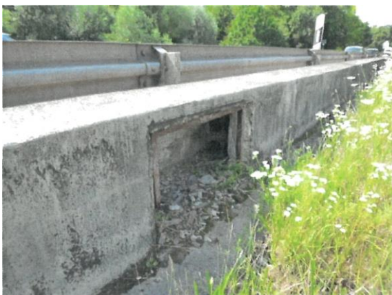
Kabelkanal, Leerrohrtrasse auf westlichem Kragarm
