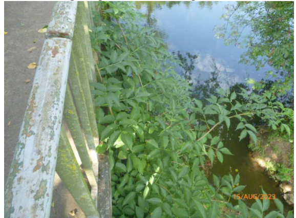
2023_BEWUCHS ZU DICHT AM BAUWERK
