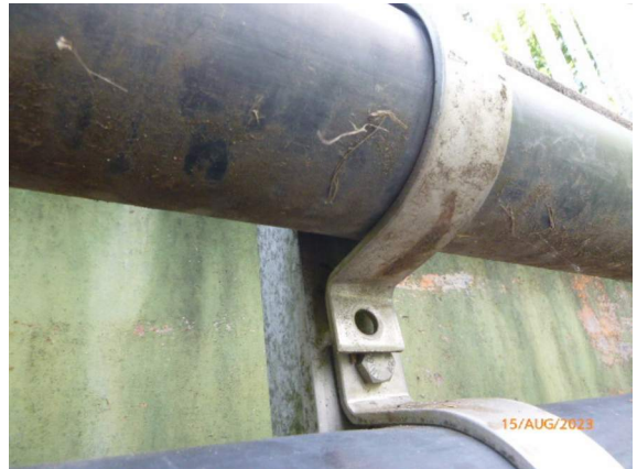
2023_LEERROHRE BEFESTIGUNGSMITTEL FEHLT
