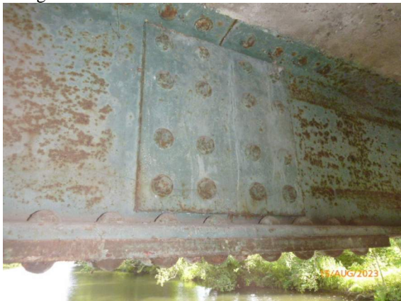
2023_LÄNGSTRÄGERSTOSS SCHRAUBEN KORRODIERT
