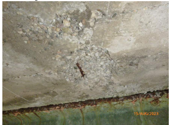
2023_PLATTE FREILIEGENDE BEWEHRUNG
