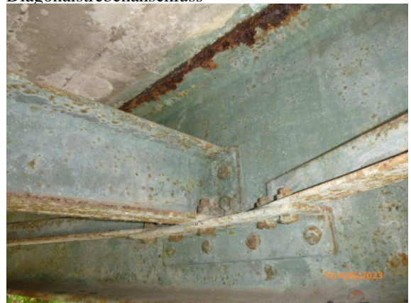
2023_DIAGONALSTREBENANSCHLUSS SCHRAUBE KORRODIERT
