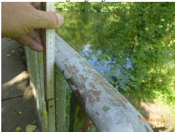
2023_GELÄNDER HÖHE ZU GERING
